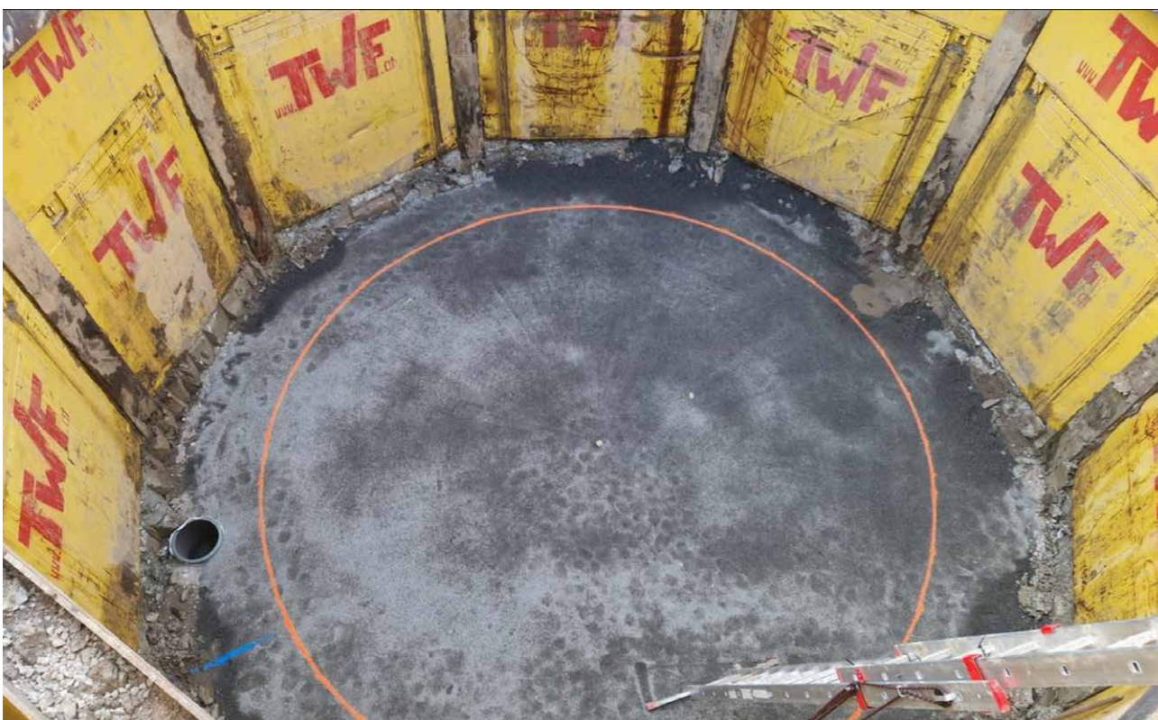
Die runde Baugrube für den Sandfang in Frankfurt an der Oder kurz vor Einbringen des Lamellenklärers. Foto: Strabag/Michel Brandt
